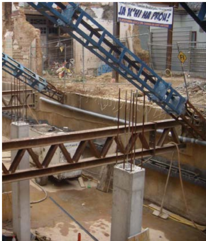
Figura 4. Ejemplo de error con consecuencias muy graves: durante la ejecución de este muro cortina de micropilotes no se entibó, por lo que el muro se deformó excesivamente y el edificio medianero colapsó.
